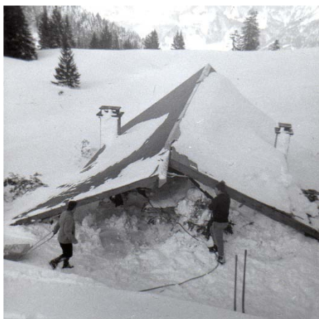
Von der Lawine eingedrückte Mauer
